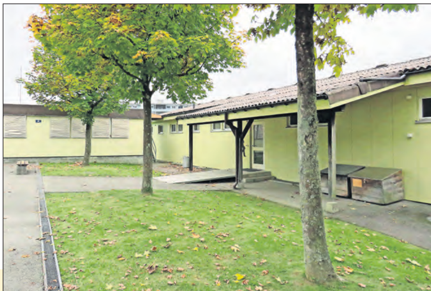
Sanierungsbedürftig – die Schulanlage Kehlhof.
